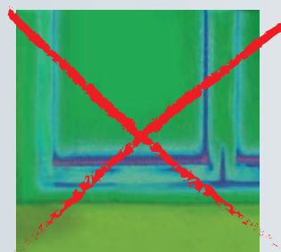
Mit der aufgesetzten Glasleiste gibt es eine kriechende Kälte (blauer Bereich)
